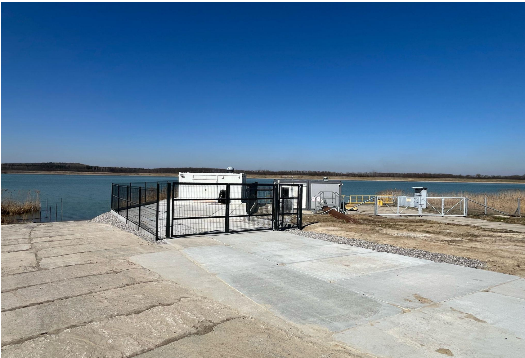
Widok stanowisk pompowych w Piasecznie
